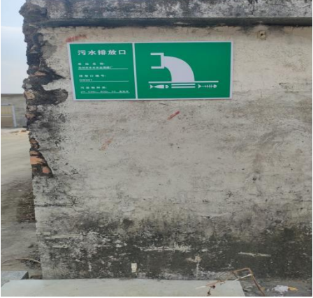
污水排放口标志牌远照
